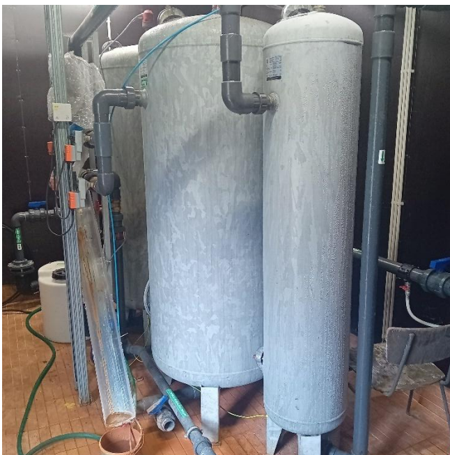
Joonis 5-8 Tööstuse puurkaevpumpla sisevaade, eelaeratsioonimahuti ja paarisfilter
